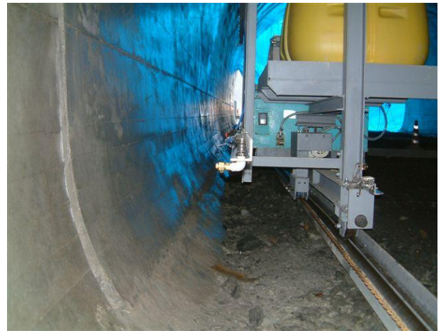
散水養生装置走行部
