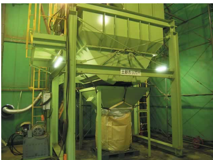
浄化土積込設備
